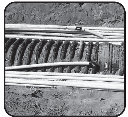
Einfacher Anschluss der Anbindeleitungen mit Heizwendelschweißmuffe
