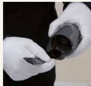
7. Klebstoff auf der Fittinginnenseite von innen nach außen in Längsrichtung (axial) relativ dünn einstreichen.
